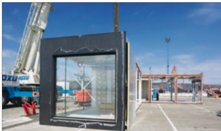
Instalación de los primeros módulos de la nueva terminal, en La Osa.
